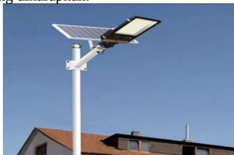
Gambar 1.3 implementasi lapangan penerapan microcontroler pada pju basis panel surya
