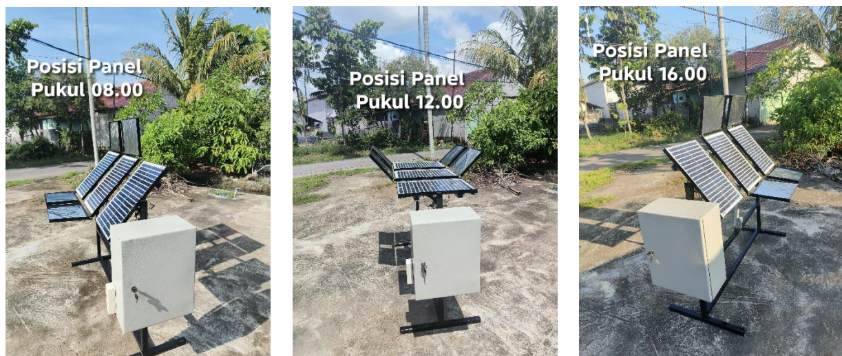
Gambar 4 Pengujian Alat PLTS Solar Tracker Reflektor
