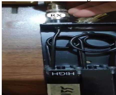
Gambar 6 kabel ANT RX dihubungkan ke duplexer freq high
