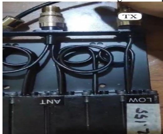
Gambar 5 kabel ANT TX dihubungkan ke duplexer freq low
