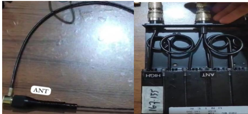
Gambar 7 kabel ANT Gambar 8 kabel ANT dihubungkan ke duplexer ANT
