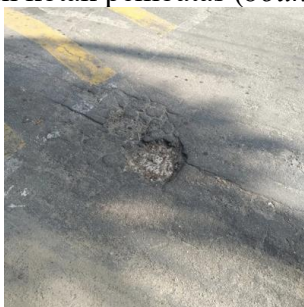
(a) Rusak ringan
