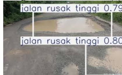
(c) Jalan rusak tinggi
