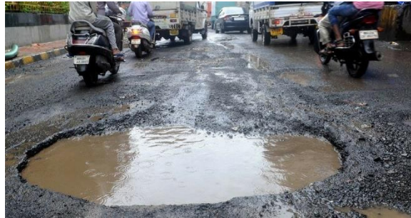
(c) Rusak tinggi
