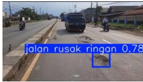
(a) Jalan rusak ringan
