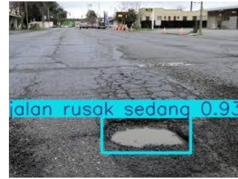
(b) Jalan rusak sedang
